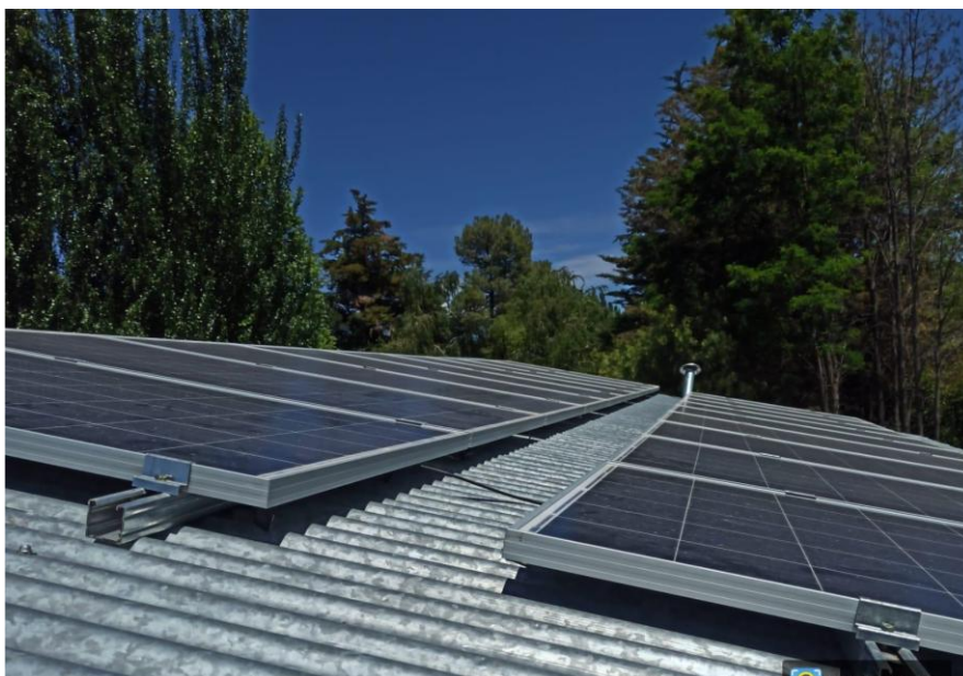
Foto 5. Paneles solares instalados en el establecimiento de Carlos Iacono
