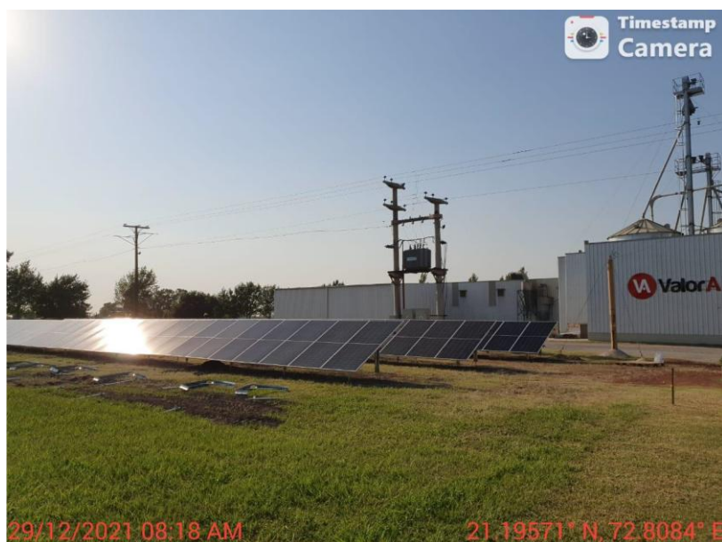
Foto 2. Paneles solares instalados
