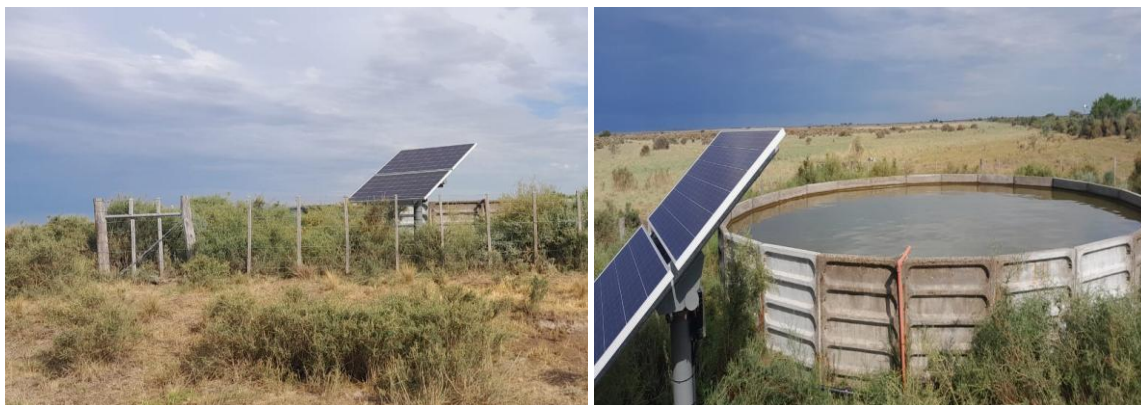
Foto 11. Paneles solares instalados en el establecimiento de Rubén Pérez
