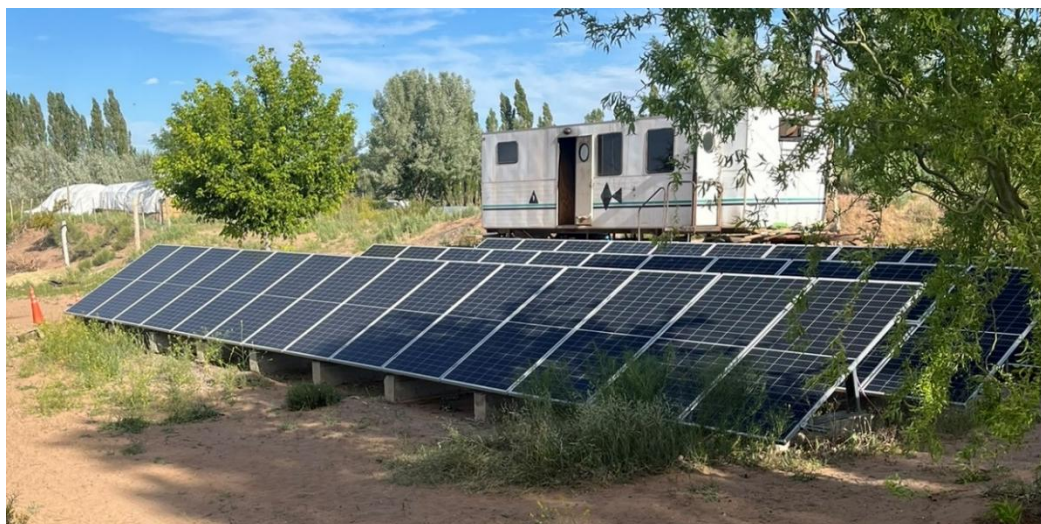
Foto 7. Paneles solares instalados en el establecimiento de Adrián Fontana
