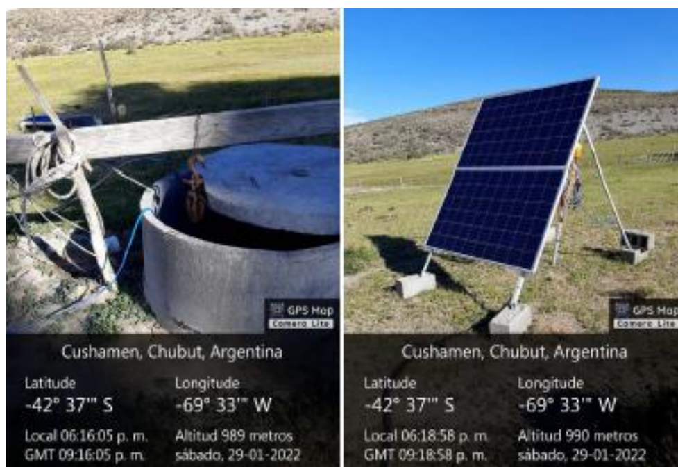
Foto 15. Bomba sumergible y paneles solares instalados en el establecimiento de Juan Raposeiras
