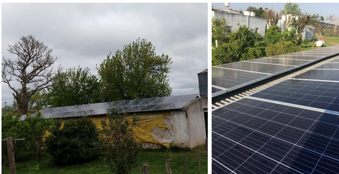
Foto 16. Paneles solares instalados en el establecimiento de Cristóbal José Lell
